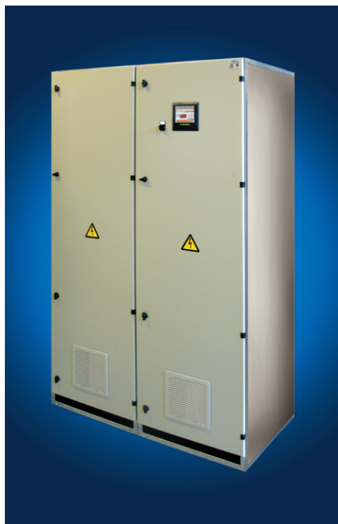
Attēls 5 zemsprieguma kondensatoru automātiskās vadības sadalne
